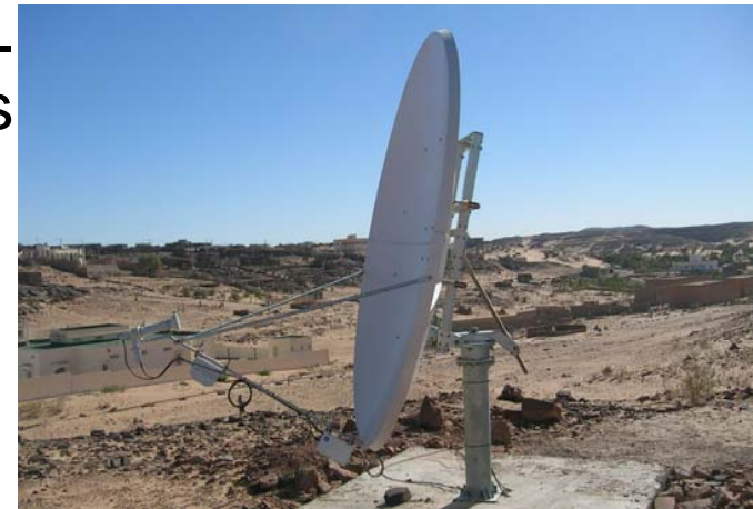
Antenne VSAT, Aoujeft
